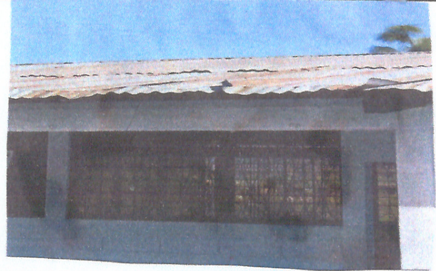
Foto 2: deterioro del techo
