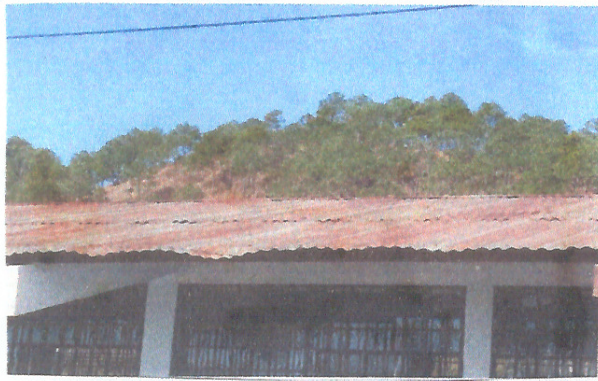
Foto 1: deterioro del techo
